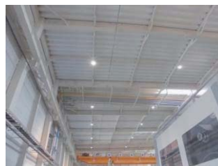
工場天井照明
