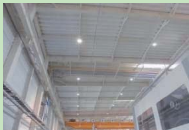
工場天井照明
