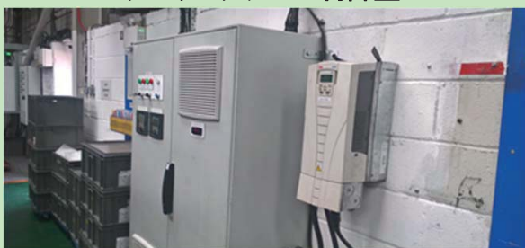
クーリングタワー制御盤
