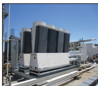
例: 相良工場 空調機
