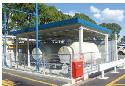
例: 相良工場 LPガス供給設備の 小型化
