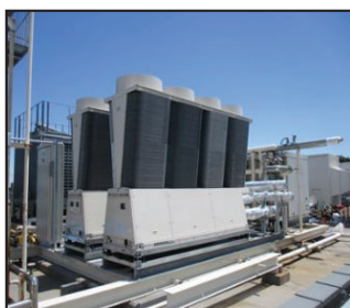
例: 相良工場 空調機
