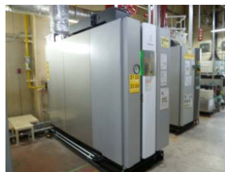
ボイラー(相良工場)
