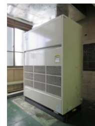
空調機(静岡工場)
